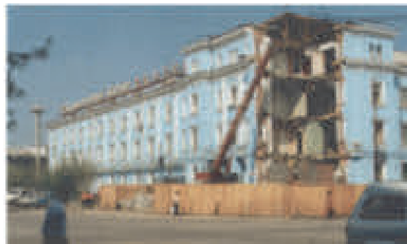
Рис. 2.8.11. Обрушение угла здания. Центр г. Якутск (Россия).
