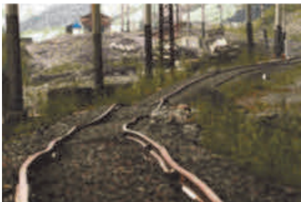
Рис. 2.8.8. Участок повреждённого железнодорожного пути.
